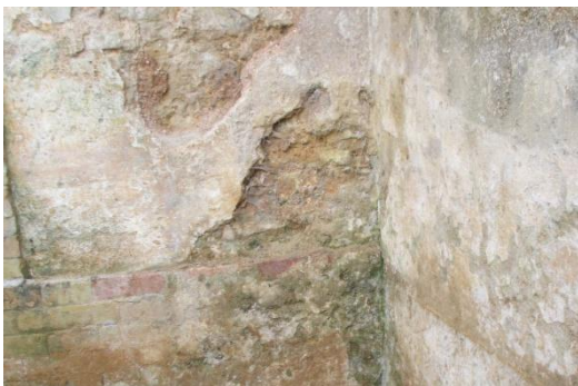
98. Restos de revestimiento en las paredes
