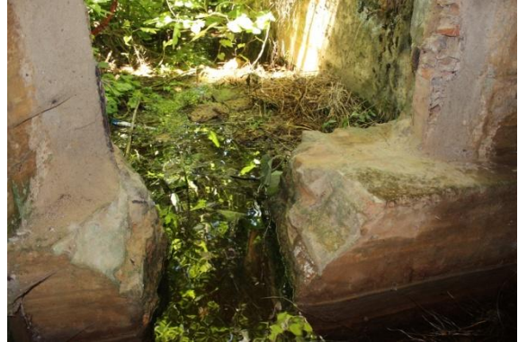
4. Rotura en el acceso a la Fuente Vieja
